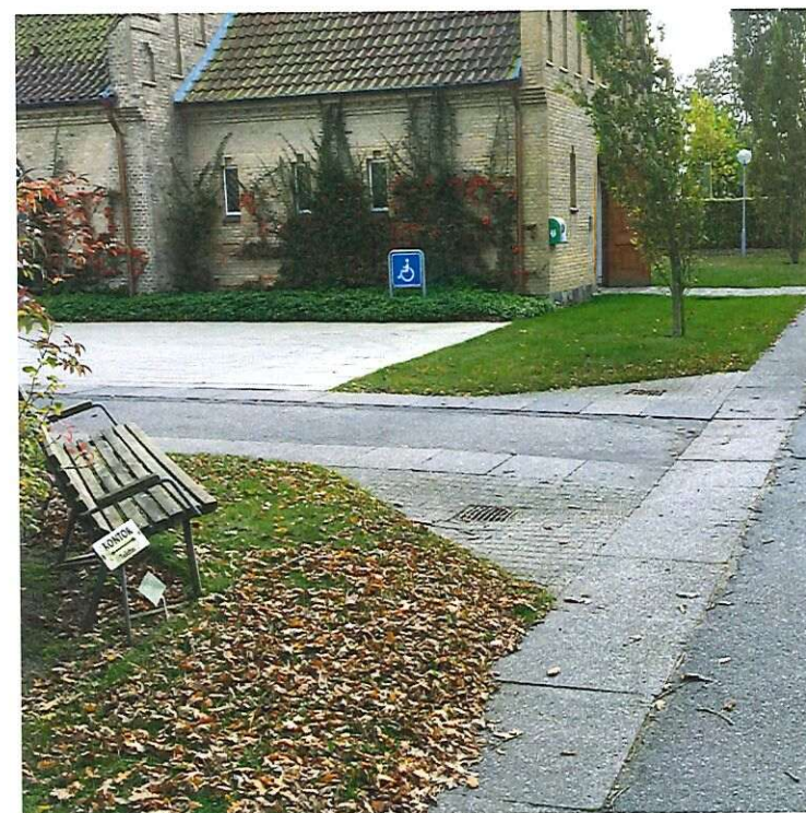
Nogle belægninger er nedslidte og derfor er der ønsket forslag til nye belægningstyper.
